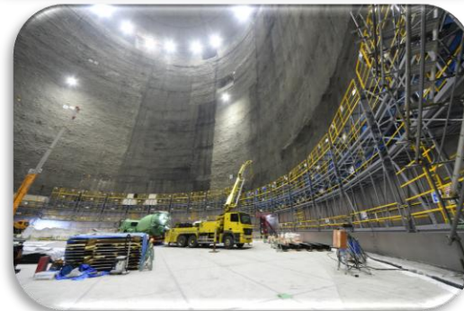
側部ライニング 建設 ・配筋 ・SUS板溶接 ・流し込みコン
